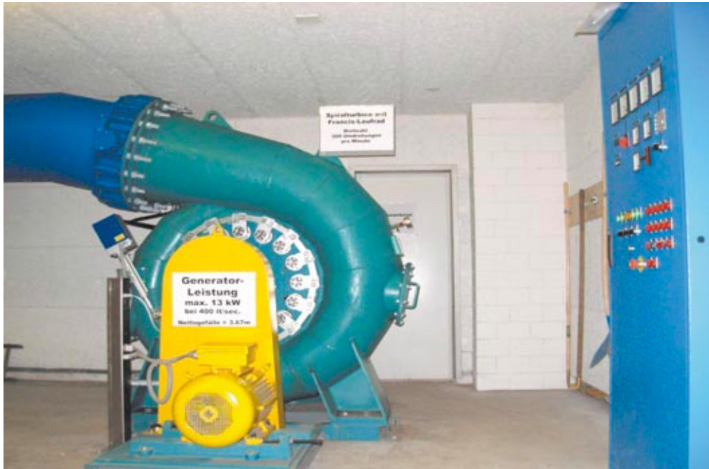
Naturstrom- Produktion: Kleinkraftwerk Bruggmühle.
